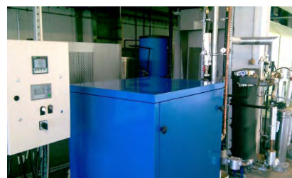
Mini-BHKW EPS 4 und im Hintergrund Wärmepumpe "Aqua Heater" zur Brauchwasser-Bereitstellung für das 55 °C-Tauchbad
