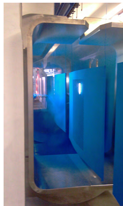
Die Pulverbesehtung; das Herzstück der Anlage
