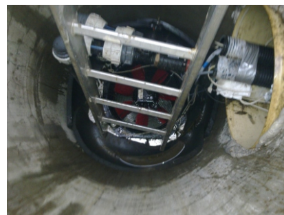
Einbausituation Wärmetauscher mit Lüfter von oben gesehen
