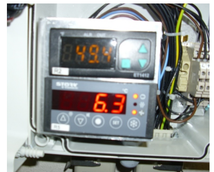
Steuerteil Sole-Wasser-Wärmepumpe oben: Temperatur Heißgas Kältemittel unten: Temperatur Sole aus Kanal
