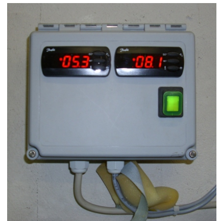
Temperaturanzeige der Messfühler PT 1000 im Schacht links: Temperatur nach Wärmetauscher rechts: Temperatur vor Wärmetauscher
