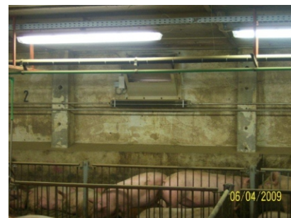
Edelstahlverrohrung der Heizleisten
