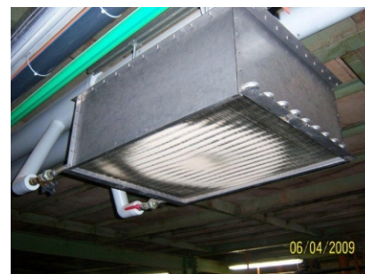
Wasser-Luft-Wärmetauscher für Erwärmung der Zuluft
