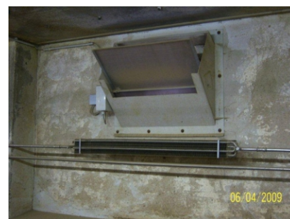
Zuluftöffnung mit darunter liegender Heizleiste
