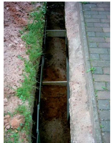
Einbausituation der Wätas-Erdwärme-Absorber-Module
